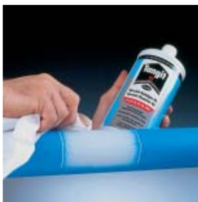
Fig. 42 3. Eventueel de laszone op de buis en de boorklem met Tangit reinigen.
